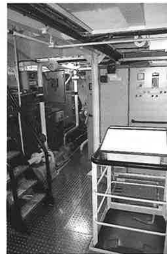
★ Machinekamer met e-motor (op de voorgrond), Mitsubishi-dieselmotor/generator en Leroy-generator/dynamo.
