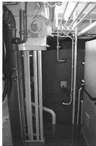
★ Warmte-accu in de machinekamer.
